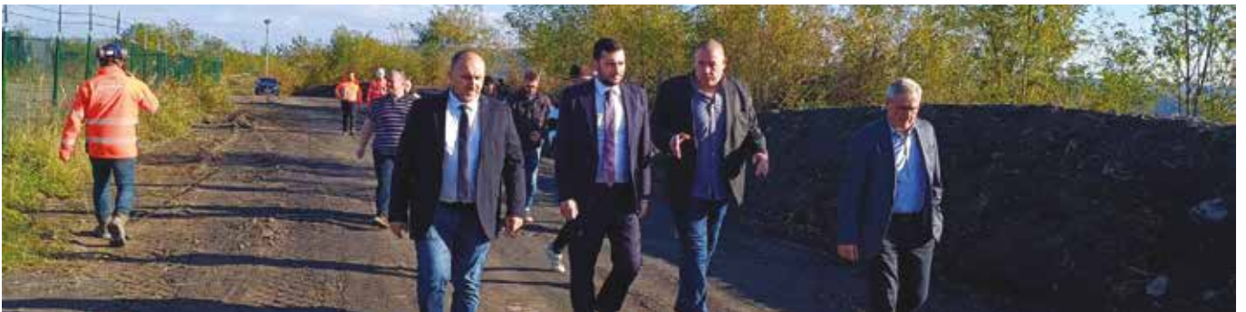
▲ La Communauté d'Agglomération de Forbach Porte de France poursuit sa politique de développement des pistes cyclables. À Forbach, des travaux d'aménagement sont en cours autour de la Carrière Centrale.
